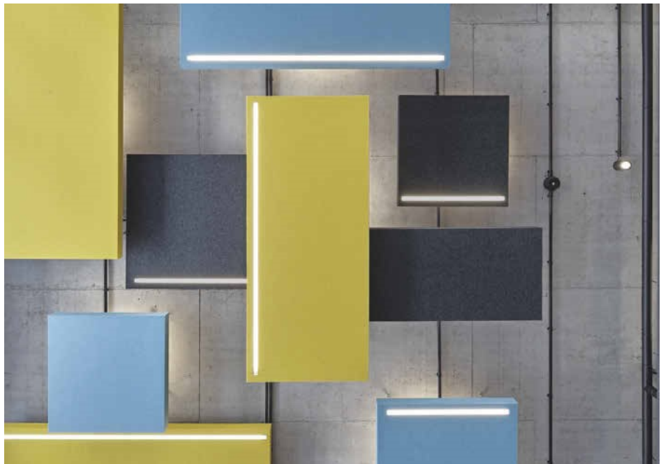
So kommt Ruhe in den Raum: Unterschiedlich dimensionierte Deckenabsorber aus mit farbigem Filz belegtem Plattenmaterial sorgen unter der roh belassenen Betondecke aufgehängt für eine verbesserte Raumakustik. Die darin bündig eingelassenen Linienleuchten ergeben ein grafisches Spiel und bieten eine akzentuierte Lichtgestaltung.
